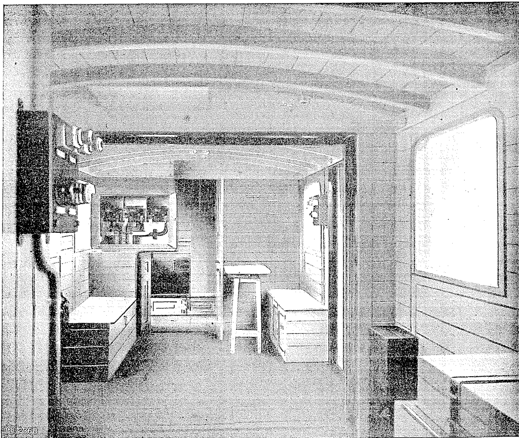
Abb. 4. Gepäckraum mit Inneneinrichtung, Licht- und Heizungsschalttafeln und Zugheizungssicherungen.
